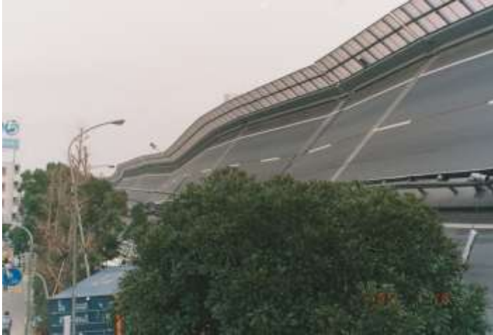
阪神高速倒壊 (東灘区)
